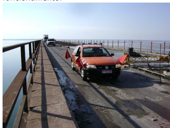
Figura 03. Carro guia para controle de velocidade do Sistema PARE&SIGA em funcionamento.
