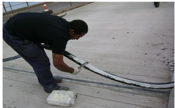
Figura 21. Execução das juntas de dilatação de borracha entre um dos pilares da ponte, com os lábios poliméricos já executados.
